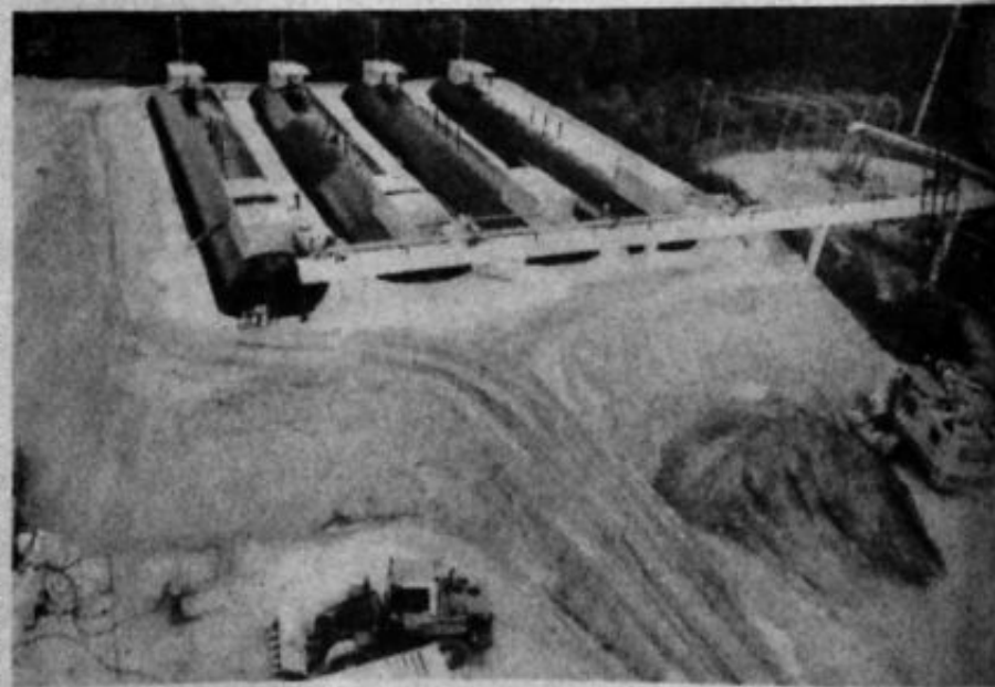
ZAHNLOSE KUBIKMETER ERDE bewegte die Firma Frye beim Einbau dieser großen Gasbehälter in Bielefeld-Sennestadt. Fotos: privat
