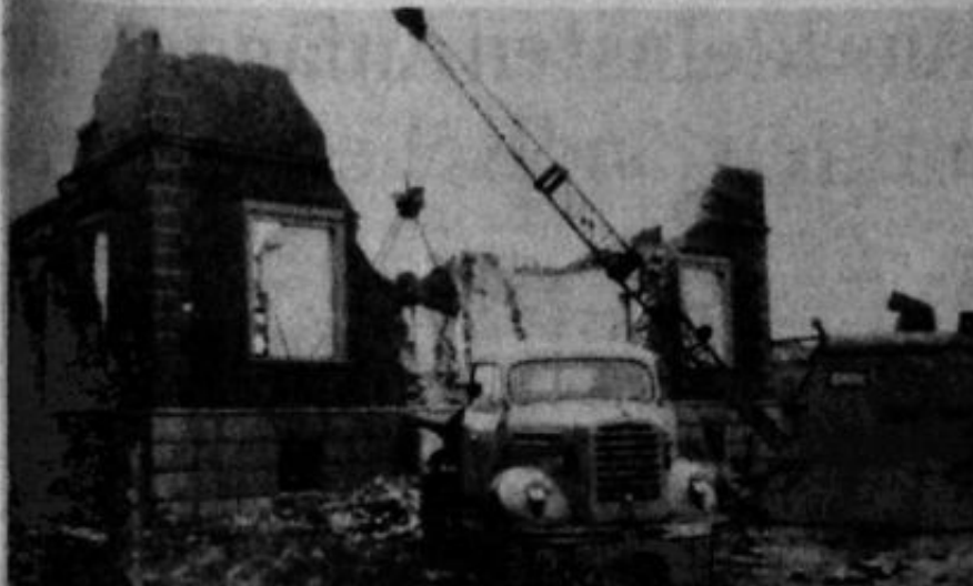
RÜCKBLLENDE: Abbruch eines Wohnhauses mit Seilbagger W6 und Greifer beim Verladen von Bau-schutt auf einen Borgward-Muldenkipper im Jahre 1961.
