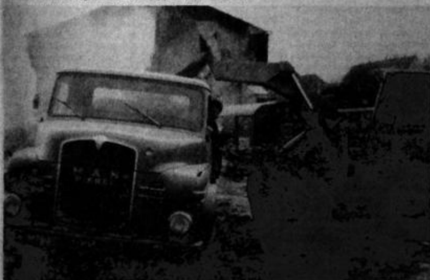
ABBRUCHARBEITEN sind seit jeher das Metier der Firma Frye. Bereits in den fünfziger und sechziger Jahren standen für solche Maßnahmen entsprechende Fahrzeuge und Maschinen zur Verfügung.
