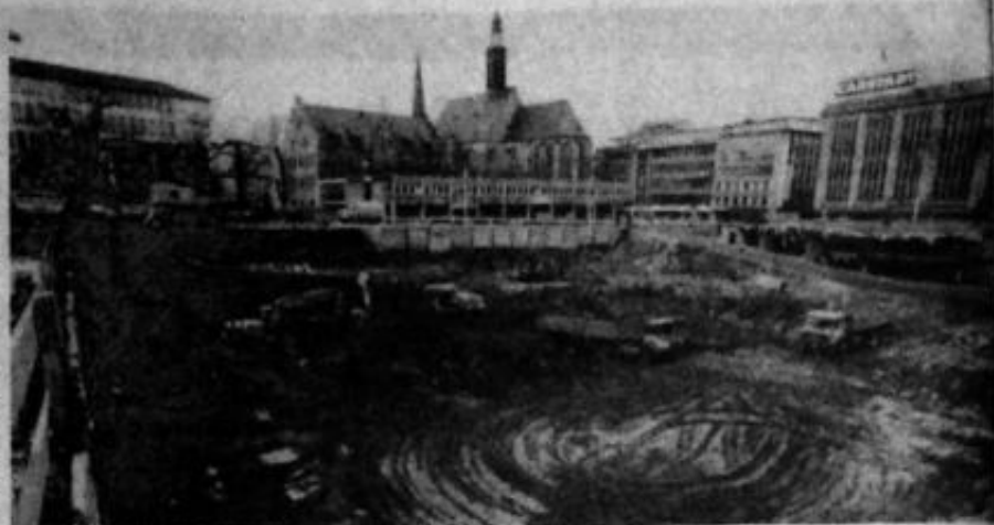
SCHAUPLATZ RUHRGEBIET: Im Vorfeld des Baues der Tiefgarage am Hansaplatz in Dortmund führte das bekannte Meller Unternehmen die Erdarbeiten durch.
