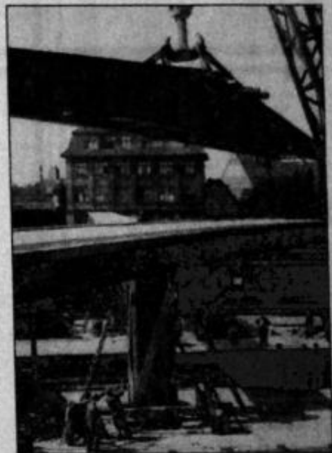
1953: DEUTSCHLANDPREMIERE in Osnabrück. Die Humboldtbrücke schwebt ein. Die erste Fußgängerbrücke im Spannbetonverfahren. Von Hein.
