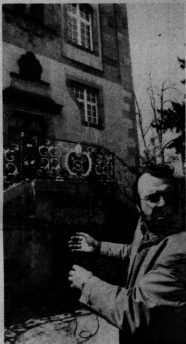
RESTAURATOR PETER BUTT erläutert das Konzept für die farbliche Gestaltung der Fassade des Abtsflügels.
